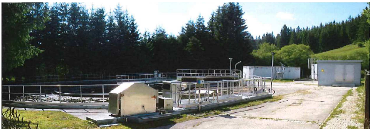
Figure 21 : Station d'épuration à Longevilles Mont d'Or - Source DORGAT
