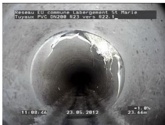
Eclatement réseau et pénétrations racines
