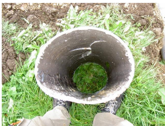
Ovalisation du réseau
