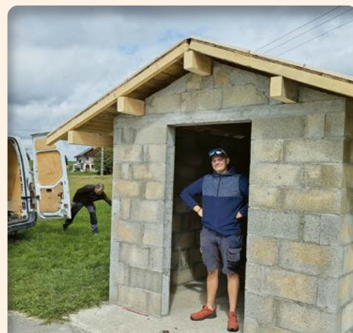
L'abribus de l'Orgère en cours de réfection par Patrice et Charly, cet été 2023
